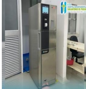
Esterilizador de baja temperatura a Central de esterilización
